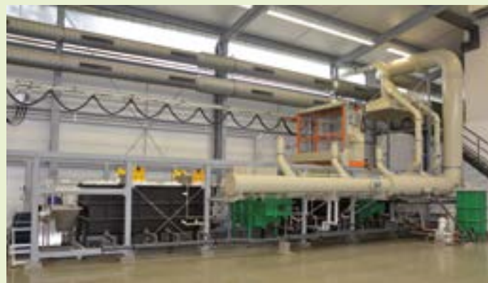
Huppertz unterstützt auch bei der Projektierung von Industrieanlagen, hier die Reinigungsanlage der Recom GmbH in Aschaffenburg.
