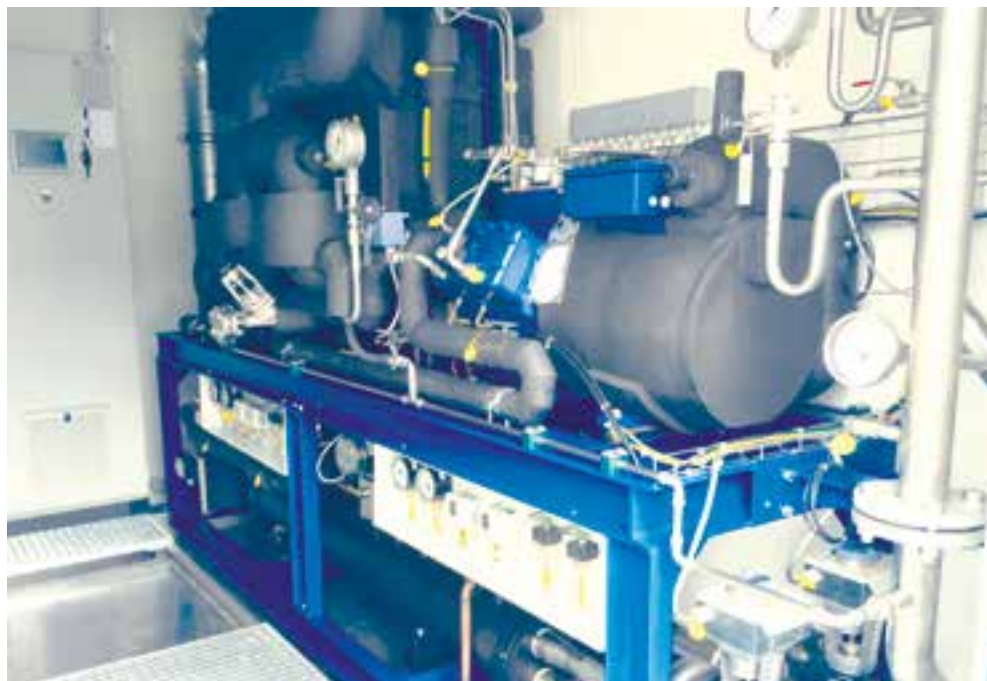
Zukunftssichere Kältemaschine mit natürlichen Kältemitteln
