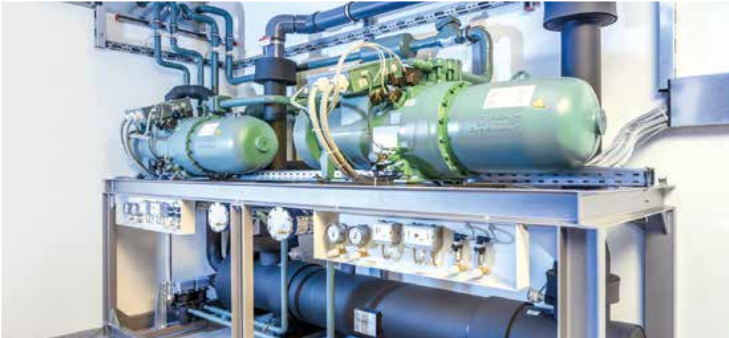
Kälteanlage nach Ecopro2.0
