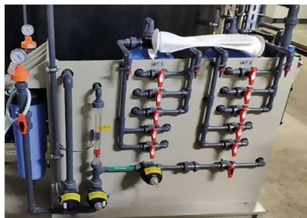
Abb. 4: Große Palladium-Recyclinganlage bei BIA Solingen (Reaktorbehälter oben, Harzsäulen mit Ventilrahmen unten)
