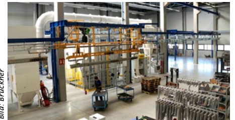
Die hochmoderne Beschichtungsanlage von Brückner Textilien
