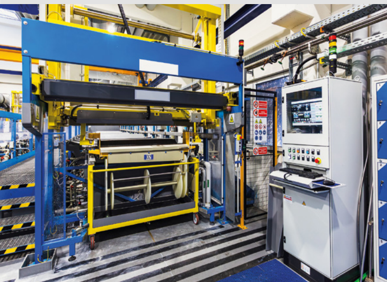
Automatisierte Galvanikanlage mit zentraler Prozesssteuerung
