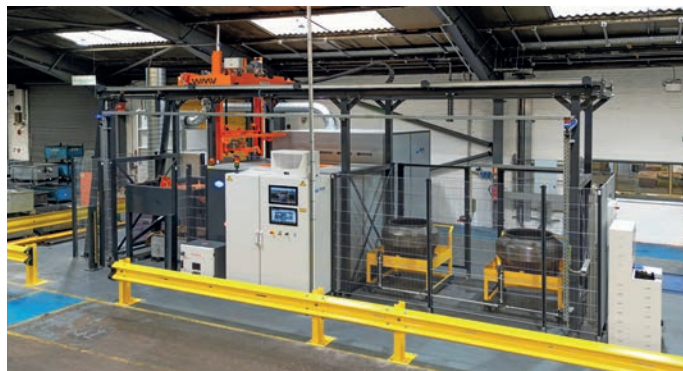
Abb. 6: Die Anlage im Werk in Großbritannien
